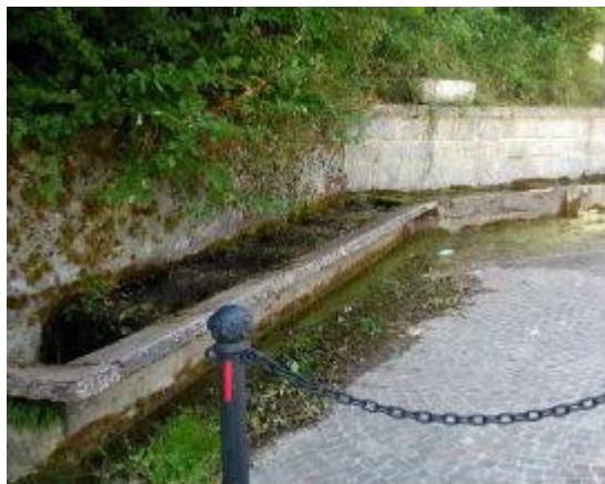
TORNIMPARTE – Degrado e abbandono.
