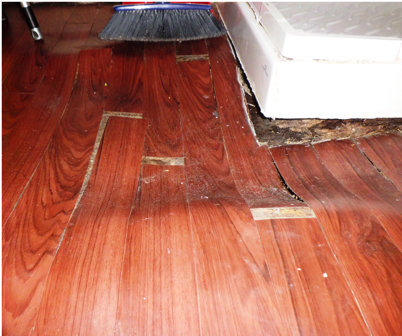
BARISCIANO - Moduli abitativi provvisori in condizioni disastrose a Barisciano (L'Aquila).
