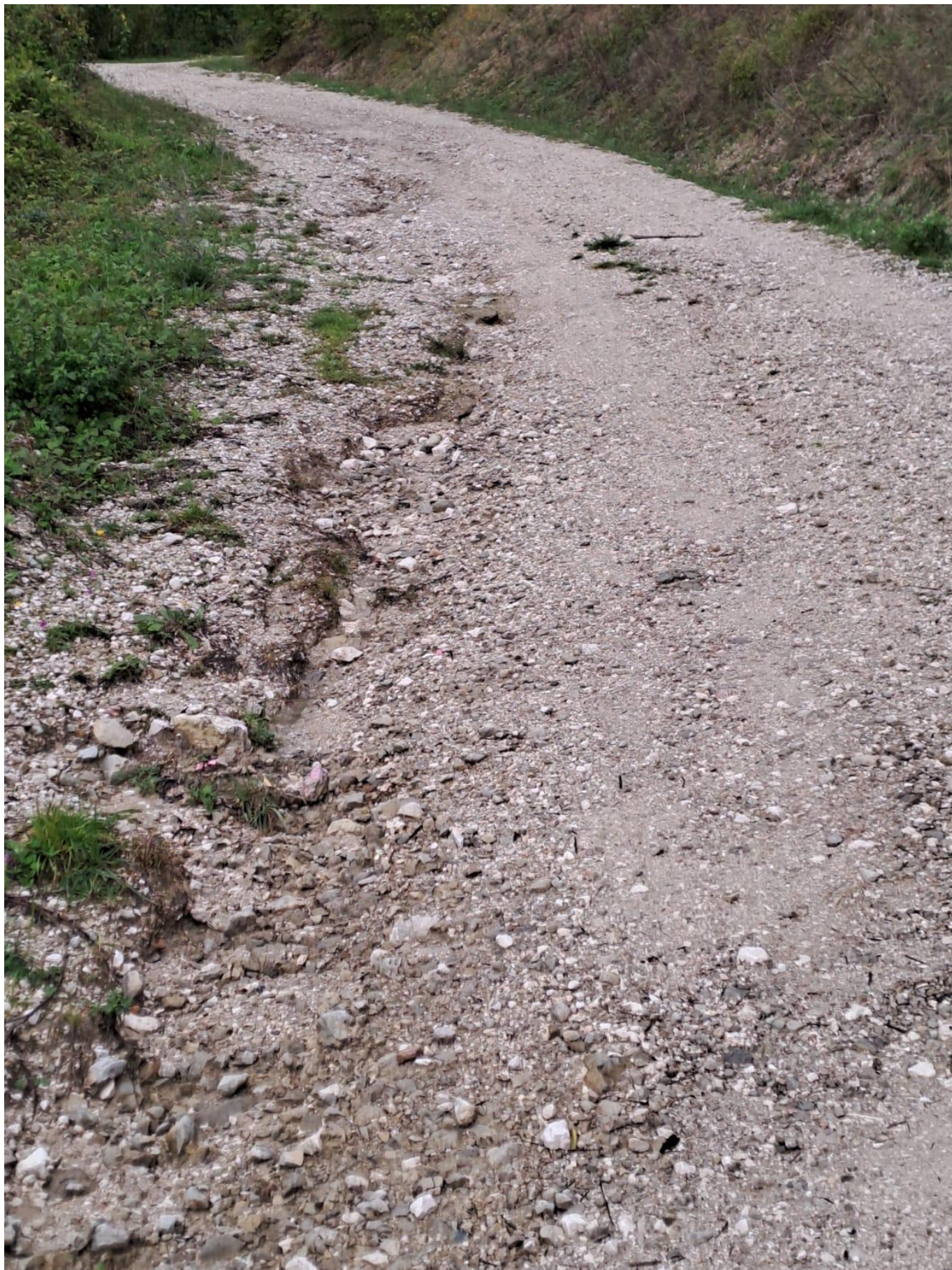
MONTEREALE- Il tratto di strada che da via Prati conduce alla strada provinciale 105 versante Cabbia è sconnesso da tempo e potrebbe essere causa di incidenti stradali. I residenti pertanto, invitano l'amministrazione comunale di Montereale
