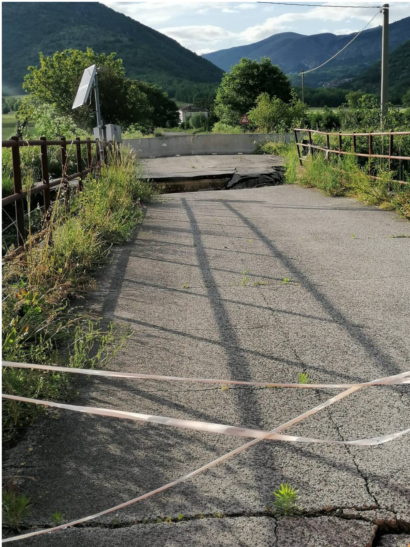
L'AQUILA - "Ci auspichiamo un rapido dissequestro del ponte di Molina Aterno. Ci sono già le risorse per smaltimento e ricostruzione della nuova struttura: ma fin quando non avverrà il dissequestro, continueranno e si acuiranno sempre più i
