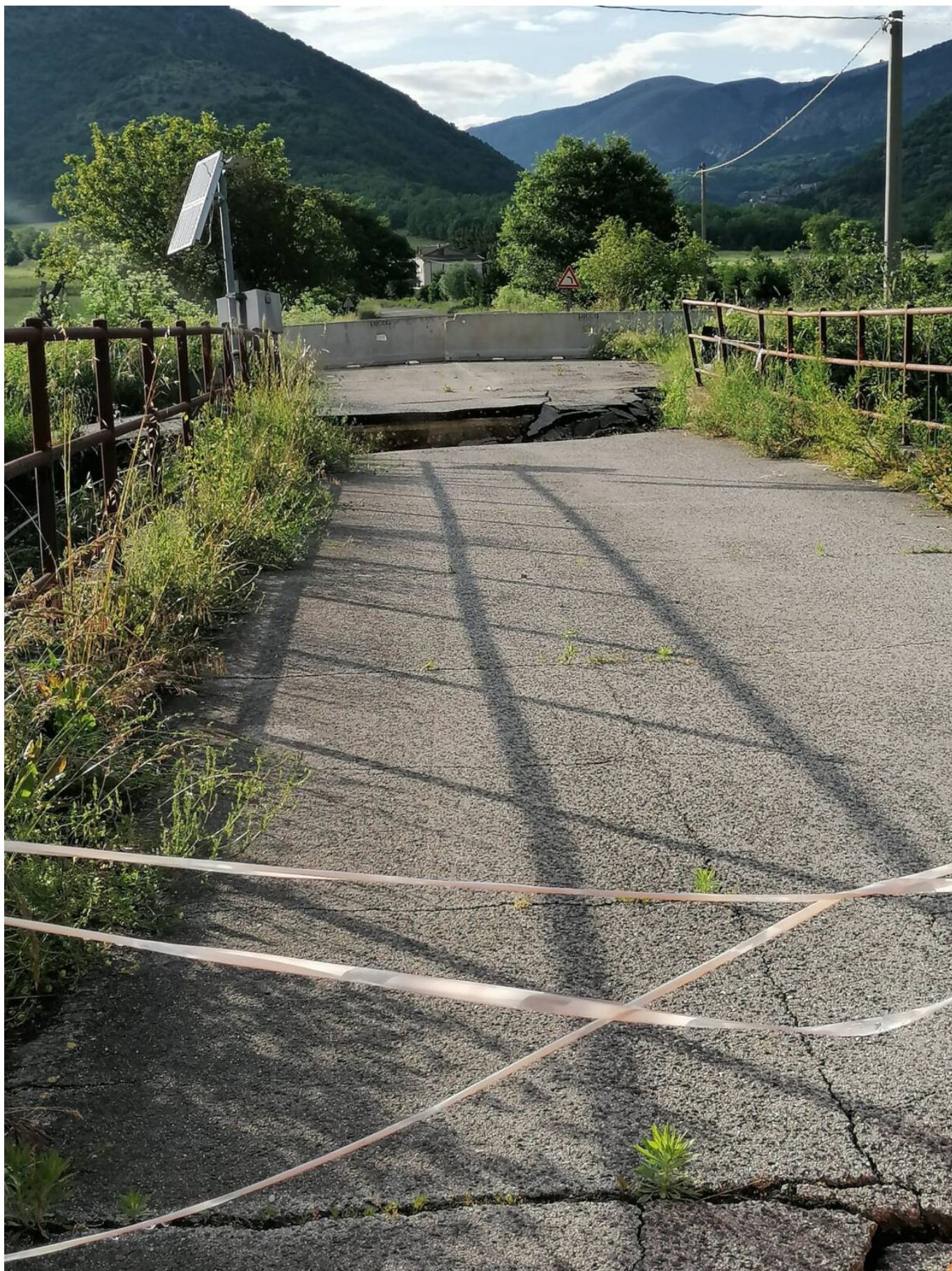
MOLINA ATERNO - Dopo più di due anni di attesa non è ancora percorribile il ponte sulla SP 11, nel territorio del comune di Molina Aterno, crollato, a causa delle piogge intense, nell'inverno 2023. Nonostante le numerose assicurazioni da parte
