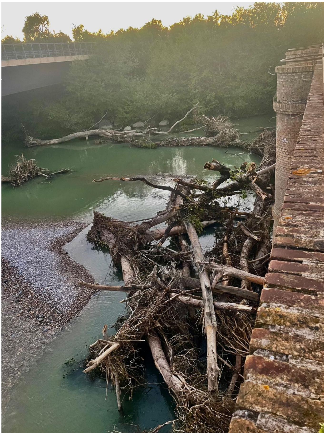
FOSSACESIA - Dopo il maltempo che ha colpito il territorio tra il 30 marzo e il 2 aprile, sono scattati interventi urgenti per la messa in sicurezza della foce del fiume Sangro, attualmente in pericolo a causa della presenza di numerosi tronchi di alberi e
