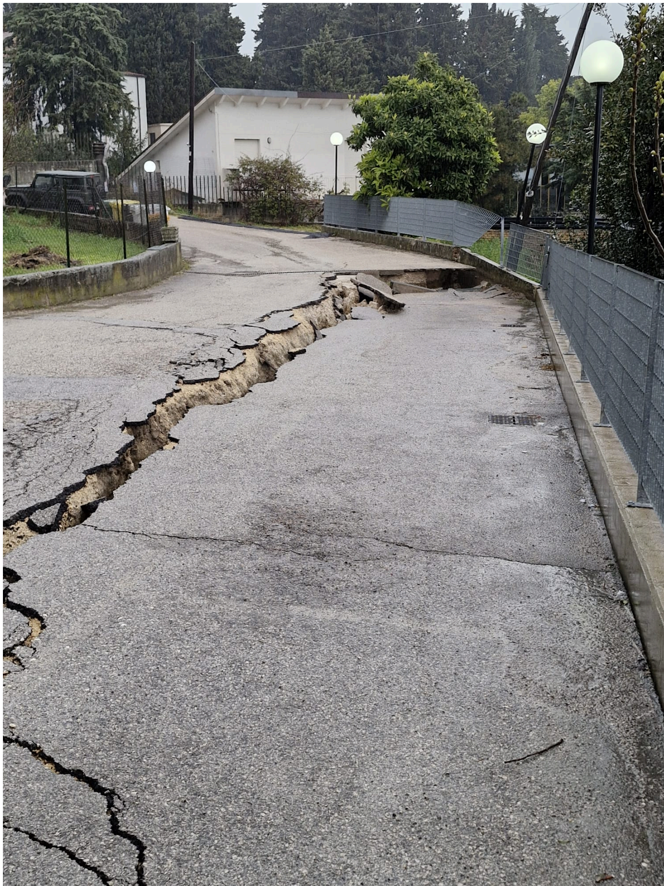
PESCARA - L'Abruzzo con il miglioramento delle condizioni atmosferiche si lascia alle spalle giorni di drammatica emergenza che ha provocato frane, smottamenti, oltre 400 sfollati, il crollo del ponte sul fiume Trigno al confine con il Molise, un
