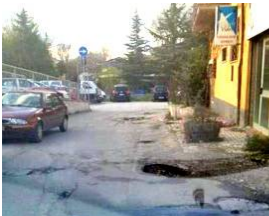
L'AQUILA - Buche giganti e pericolose su via Ulisse Nurzia.
