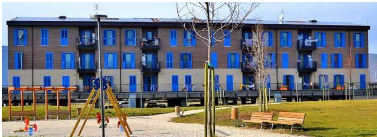
L'AQUILA - Impianti di riscaldamento fuori uso al progetto C.a.s.e. di Bazzano, all'Aquila.
