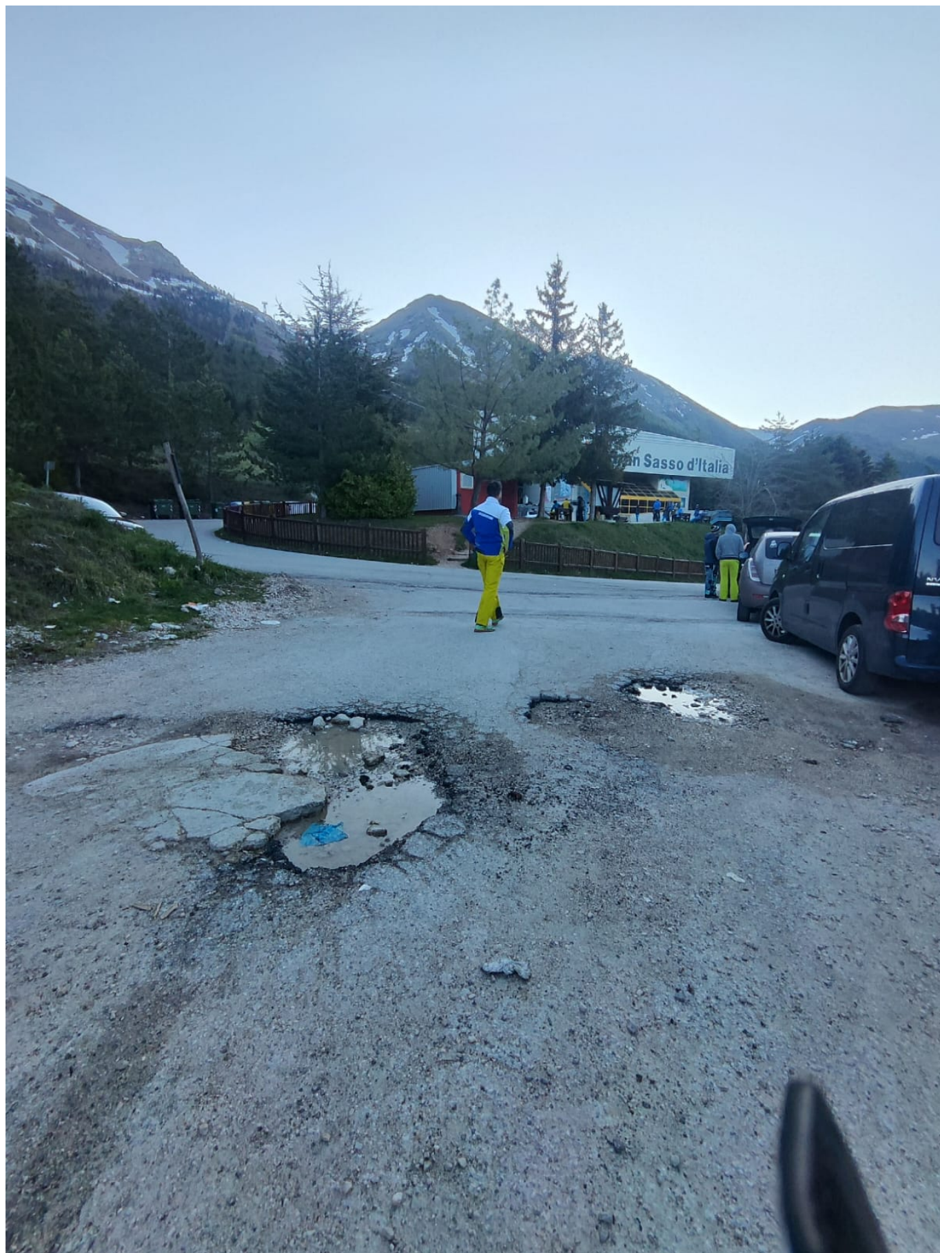
L'AQUILA - Ci sono proteste da parte dei frequentatori del Gran Sasso perchè a Fonte Cerreto, di fronte ai cassonetti dell'Asm, "ci sono delle enormi buche sulla strada, autentiche voragini, che sarebbero da eliminare subito anche perché
