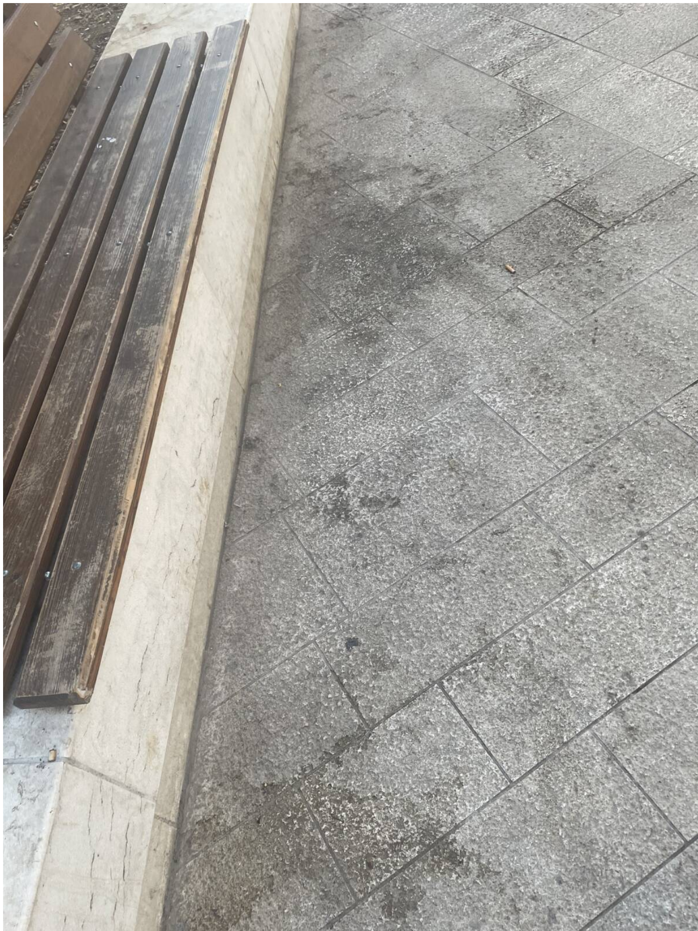
L'AQUILA - "La nuova pavimentazione del centro storico a L'Aquila è un disastro, è un disastro da qualsiasi angolo venga analizzata o guardata. Sul lato estetico e storico. E purtroppo è stata scelta una pezzatura della pietra, che non ha permesso
