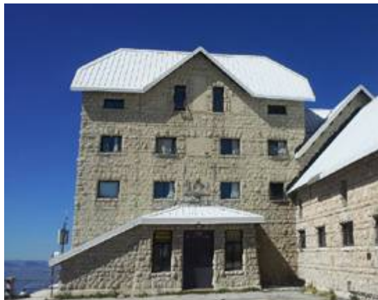
L'AQUILA - Vetri rotti, finestre aperte, degrado assoluto.
