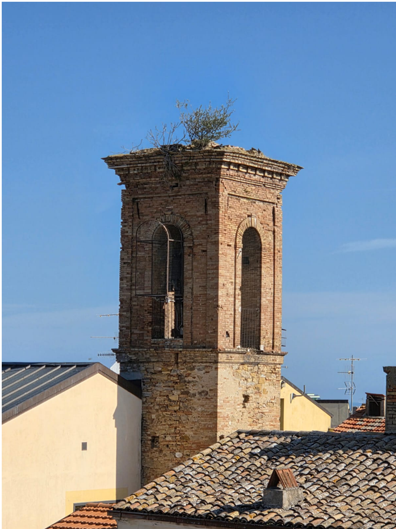
FOSSACESIA – A seguito del violento nubifragio che ha colpito Fossacesia (Chieti) il 3 agosto scorso, accompagnato da una tromba d'aria, grandine e forti piogge, è stato rilevato un grave danneggiamento del campanile storico della Chiesa del
