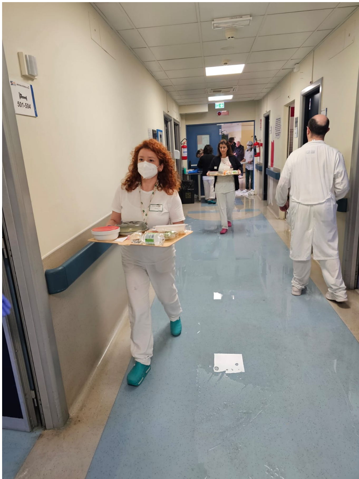
TERAMO – Questa mattina per la rottura di una valvola di intercettazione di una manichetta antincendio un forte getto d'acqua si è riversato lungo il corridoio dell'ala C del reparto di Medicina al quinto piano dell'ospedale di Teramo. Il sistema
