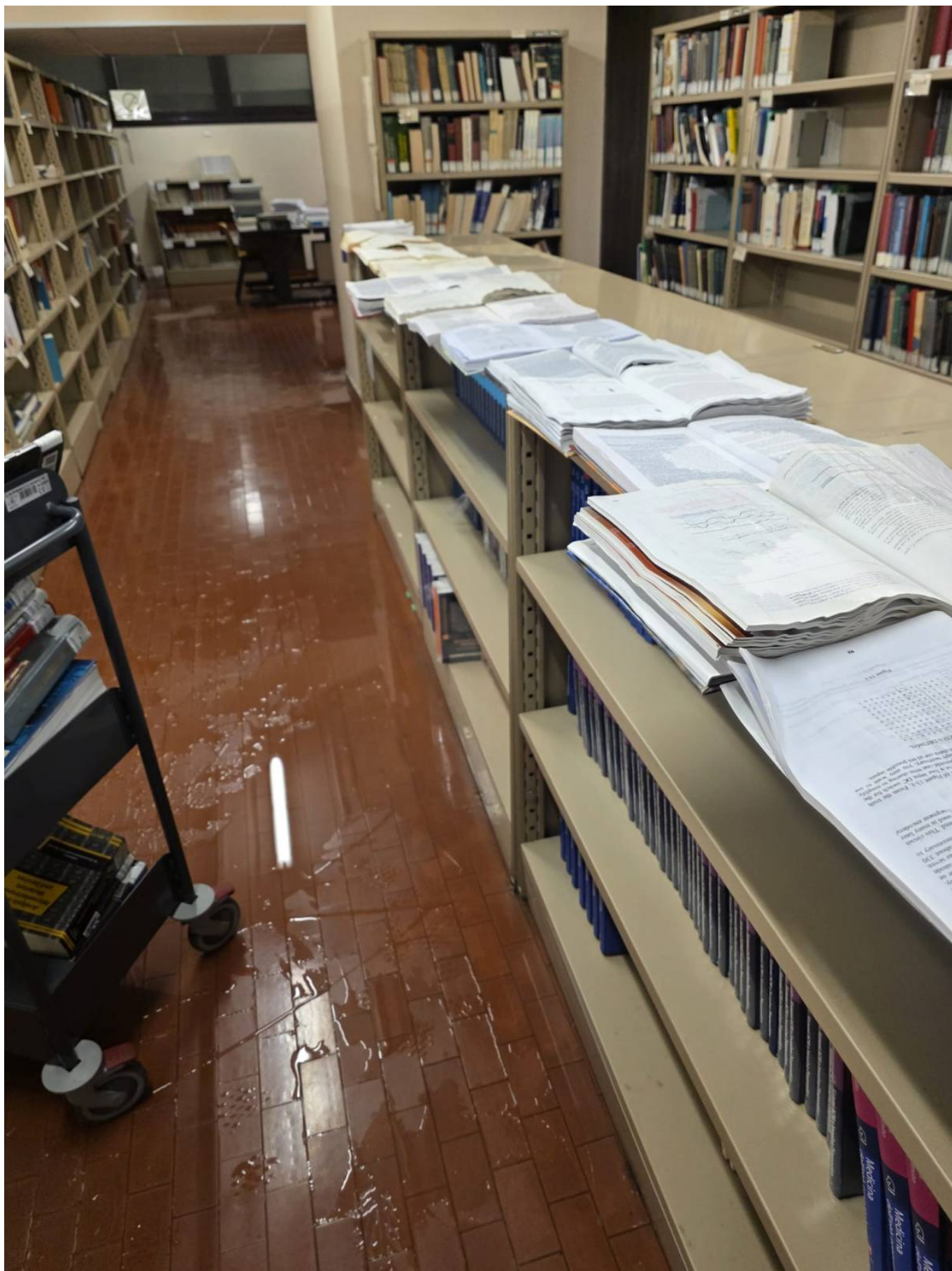
L'AQUILA - "Nella serata di ieri, lunedì 29 dicembre, presso l'edificio Renato Ricamo (Coppito 1) dell'Università degli Studi dell'Aquila si è verificata la rottura di una sezione dell'impianto antincendio che alimentava un idrante soprassuolo esterno.
