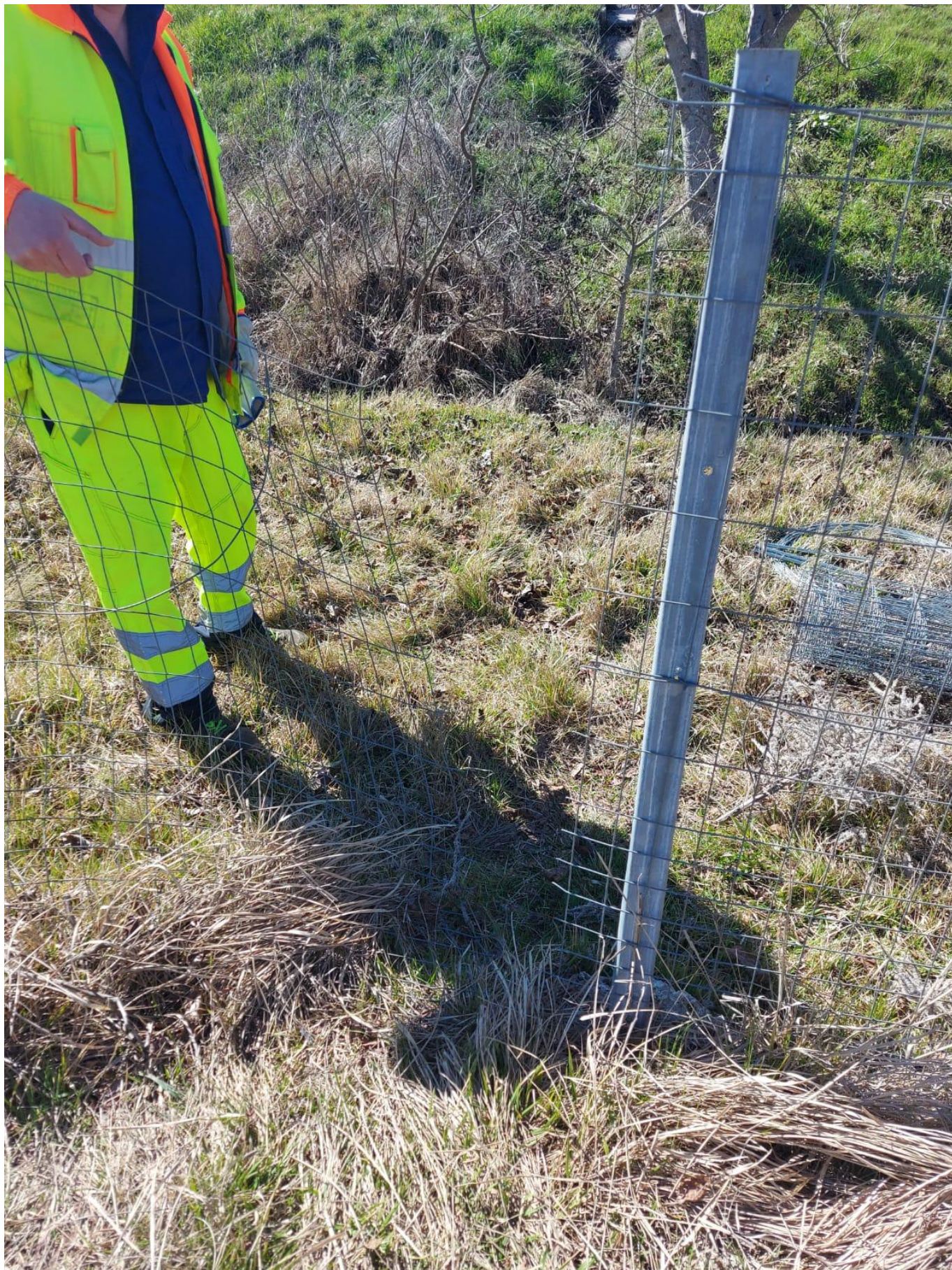
L'AQUILA - Reti di protezione tagliate di netto con le cesoie da parte di ignoti, e cinghiali che sono entrati attraverso i varchi nella carreggiata dell'autostrada A25, tra il casello di Magliano de' Marsi e quello di Avezzano, in provincia dell'Aquila,
